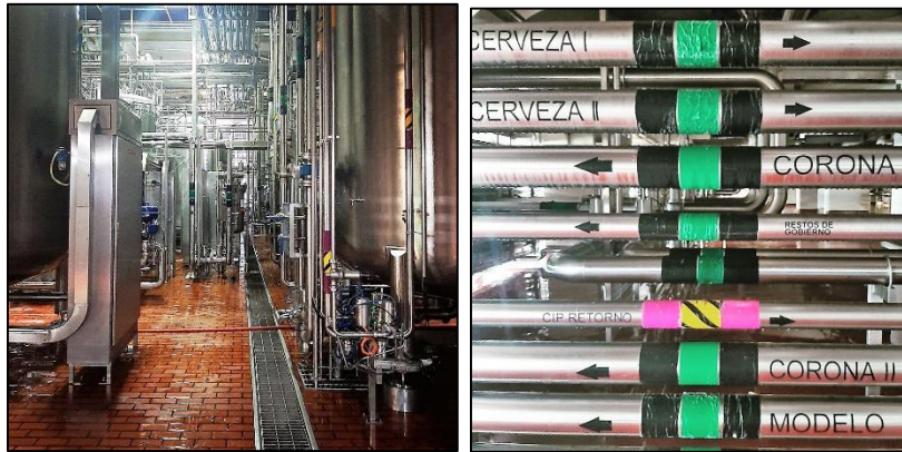
Imagen 3.9. Sistema de bombeo, control y centrifugado
